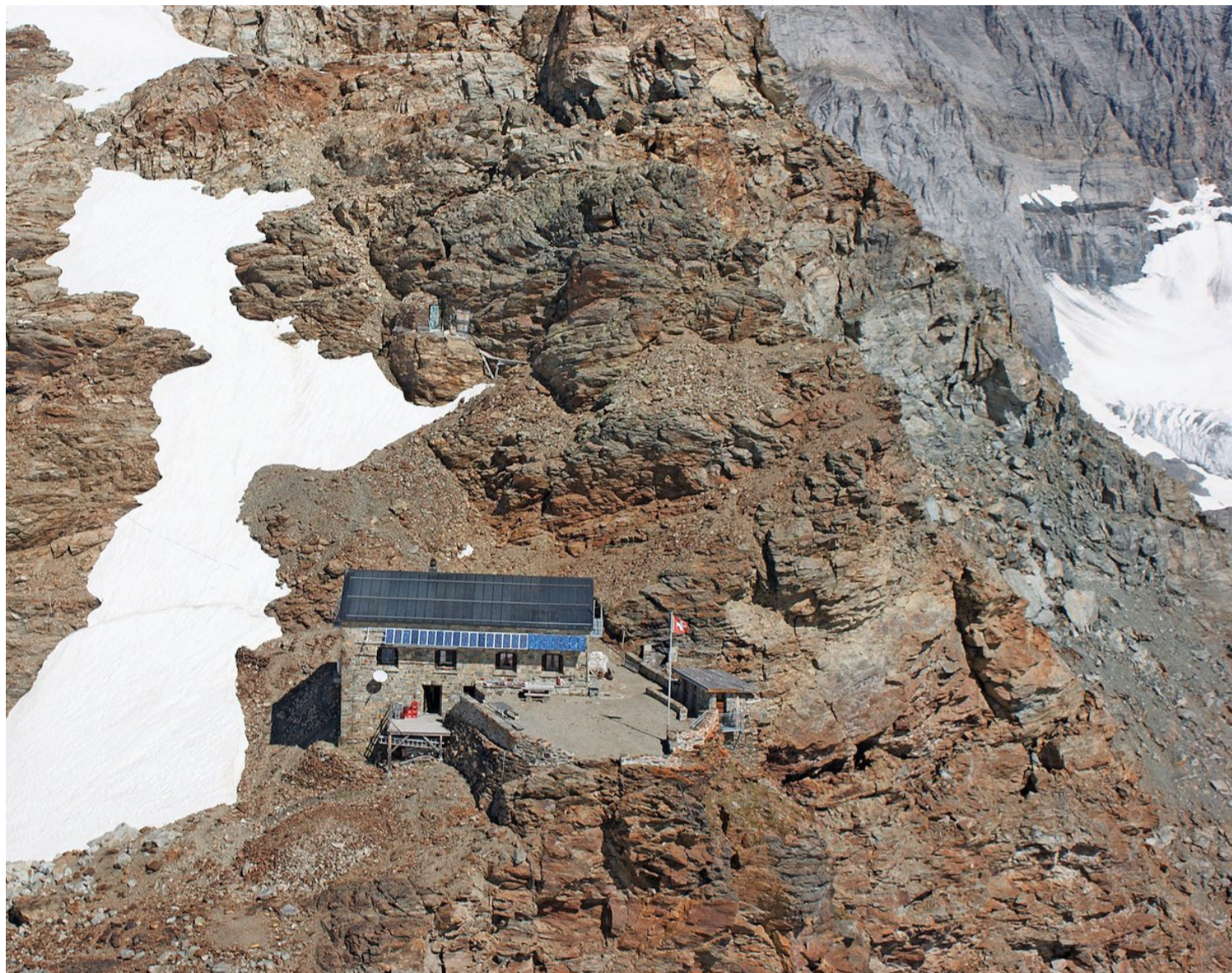
Die SAC Mutthornhütte. Darüber das rutschende Felspaket. Foto: PD
